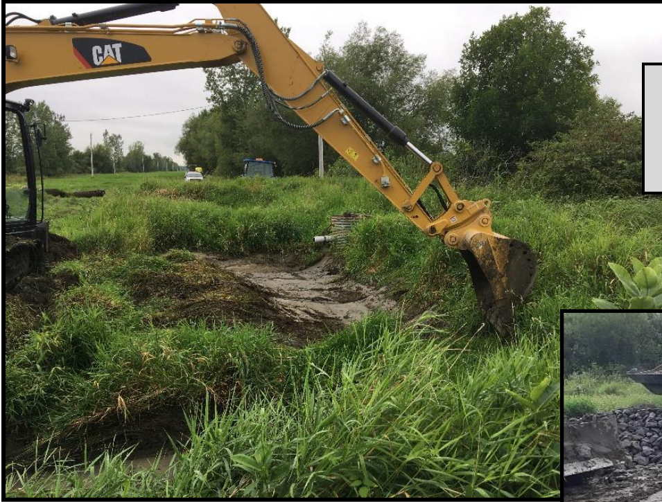
Fosse de sédimentation à la sortie de la station de pompage
