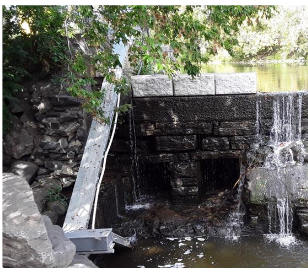
Figure 4. Échelle à anguilles de Saint-Lin–Laurentides
