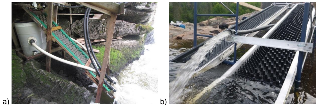
Figure 8. Passe-piège installée sur a) la rivière du Sud-Ouest (substrat conçu par Milieu inc.), b) la rivière Portneuf à Portneuf-sur-Mer (conception AECOM/CNHW)
